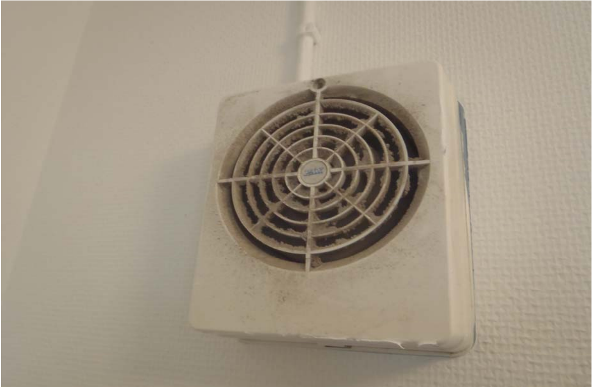
Exempel på lortigt frånluftsdon.
